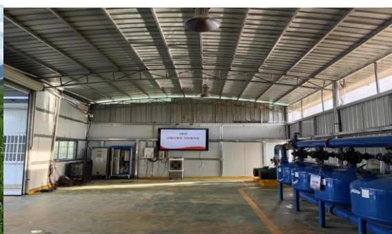
图 5 水肥一体化泵房
